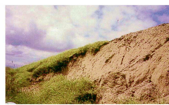
法面が崩壊している状況。水が浸透し土砂が流動化をおこしているため、こういう状態がおきる
