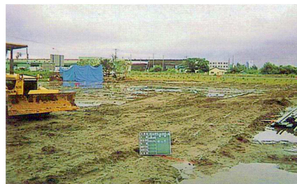
施工前 水はけの悪い状態
