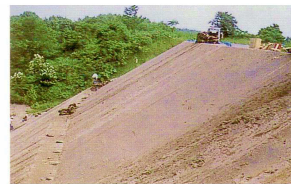
法面改良後上段 改良後台風がきて大雨降るが崩壊なし
